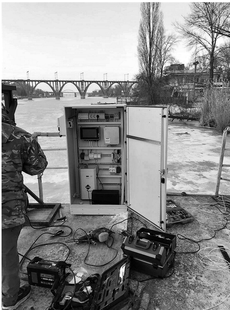
Рис. 2. Стационарна станція «Наяда-2»
